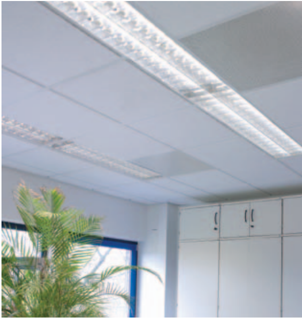
Bild 6: Opticlean eingebaut in eine Rasterdecke
