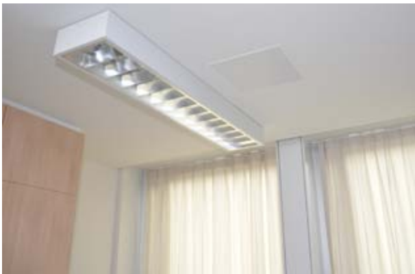
Bild 7: Opticlean eingebaut in eine GK-Decke
